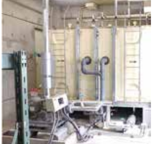
【機械室 加圧給水ポンプ、受水槽】
