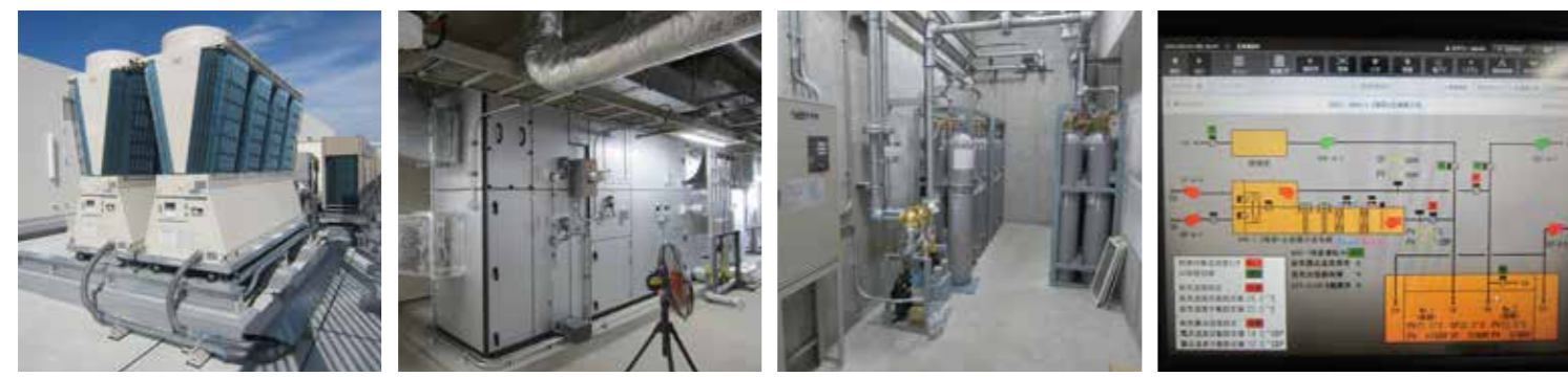
空冷ヒートポンプモジュールチャラー(第1企画展示室・収蔵庫系統) 空気調和機(第1企画展示室系統) 窒素ガスボンベ庫 自動制御グラフィック画面(第1企画展示室系統)
