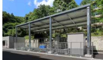
屋外特殊排水処理施設全景
