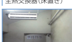
事例6 (明石公園) エアー搬送ファン
