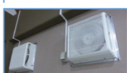
事例4 (南但馬自然学校) 普通換気扇(壁付き)
