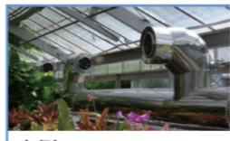
事例1 (フラワーセンター) 展示温室内吹出口
