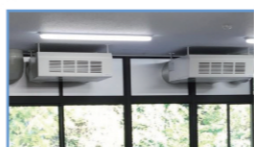
事例3 (但馬文教府) 全熱交換器(天吊り)
