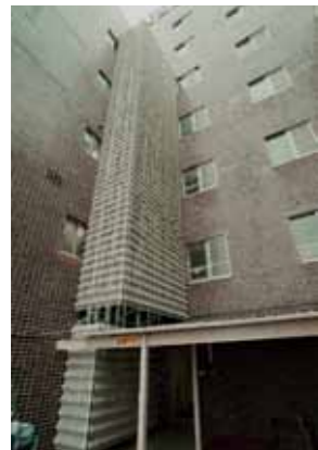
【屋外パイプシャフト】
