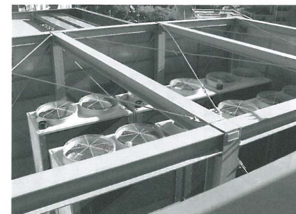
同館 屋上室外機
