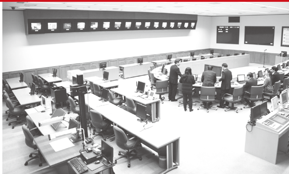
会議しやすい馬蹄形のテーブルを配置するとともに、災害に関する最新情報を提供するフェニックス防災システムなどを備えた災害対策本部室。
